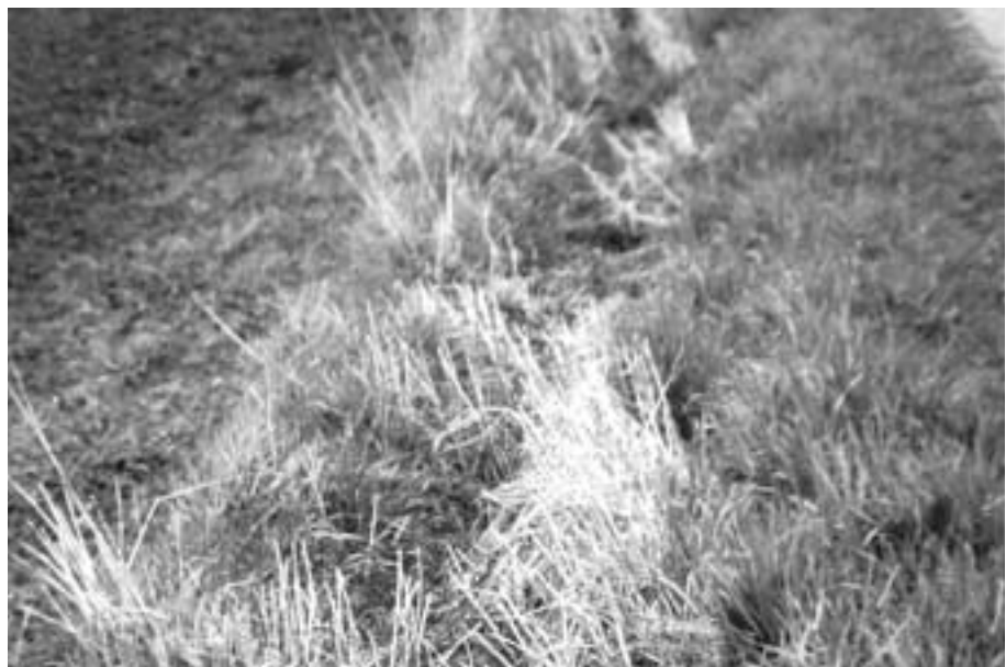
Abb. 18: Fast vollständig zugewachsener Entwässerungsgraben mit einem Substanzwert von \approx 3,5
