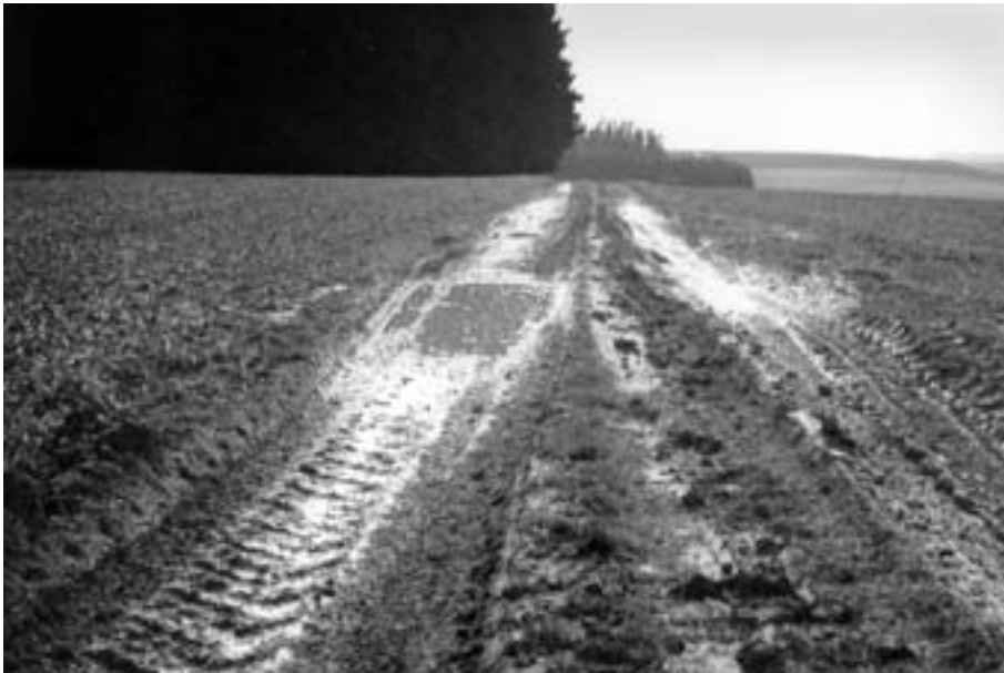
Abb. 20: Ländlicher Weg ohne Entwässerungseinrich- tungen in schlechtem Gebrauchszustand
