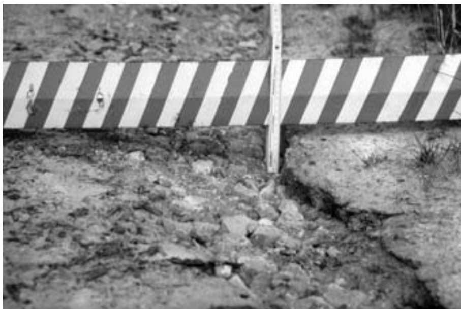
Abb. 11: Ungebundene Befesti- gung mit erodierter Ober- fläche und freiliegendem Tragschichtmaterial
