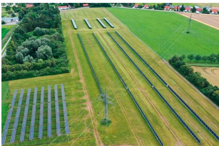
Bild 1: Die Agri-PV-Anlage in Grub besteht aus drei unterschiedlichen Agri-PV-Anlagentypen. Unten links die hoch aufgeständerte Anlage, rechts die vertikal angeordneten Module und oben die nachgeführte Anlage. (Foto: Malte Stöppler)
